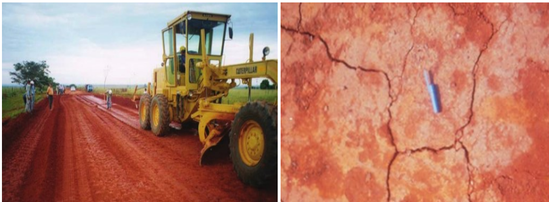
Figura 322: Conformação final da base e trincamento em função da secagem
