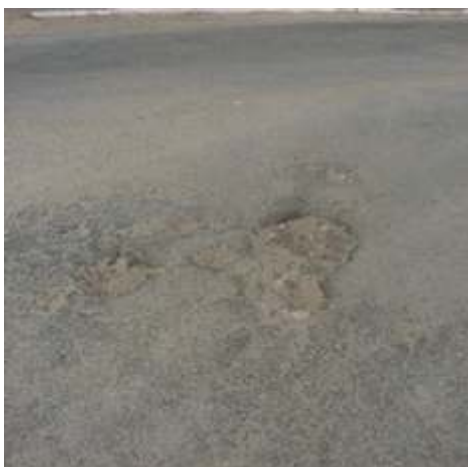
Figura P72 - Nível de deterioração alto
