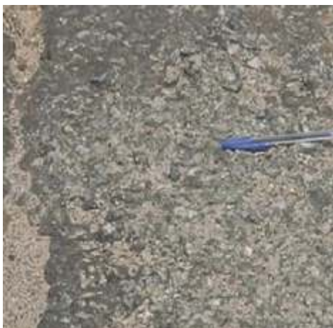
Figura S90 - Nível de deterioração alto
