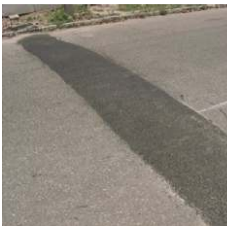
Figura R60 - Nível de deterioração alto
