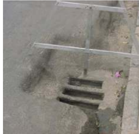
Figura D145 - Desnível da Caixa Coletora [Fonte: Avenida Jiló Guedes, Campina Grande/PB]
