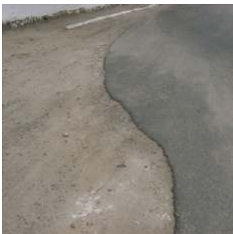
Figura S114 - Nível de deterioração alto
