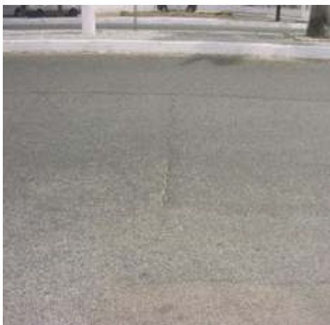
Figura T36 - Nível de deterioração alto
