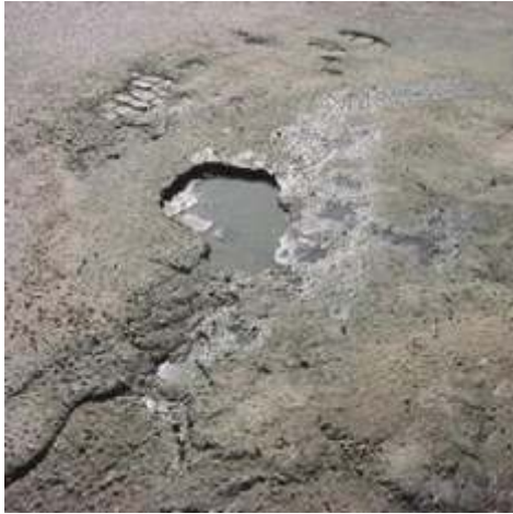
Figura D160 - Nível de deterioração baixo
