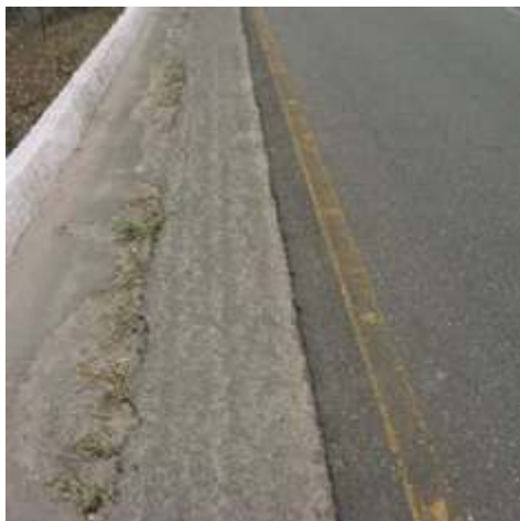
Figura S106 - Nível de deterioração baixo
