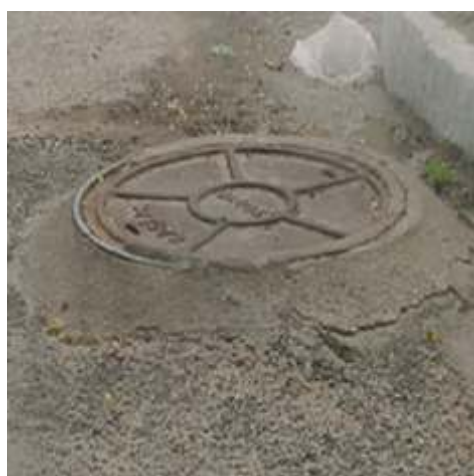
Figura D144 - Nível de deterioração alto
