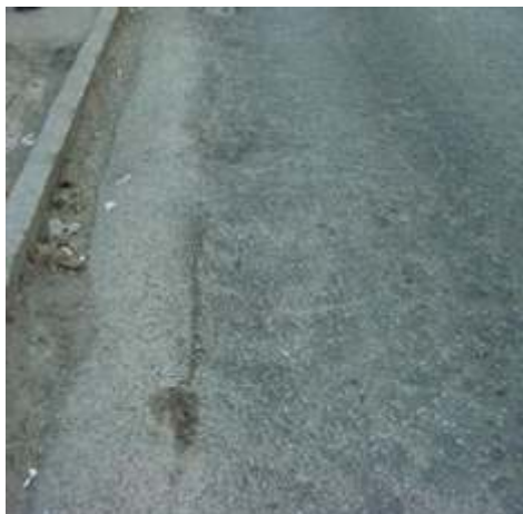
Figura S76 - Nível de deterioração baixo
