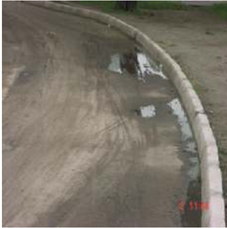
Figura D166 - Nível de deterioração baixo
