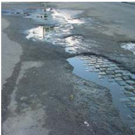
Figura D161 - Nível de deterioração médio
