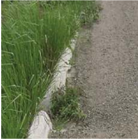
Figura D154 - Nível de deterioração baixo
