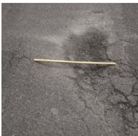
Figura R66 - Nível de deterioração alto
