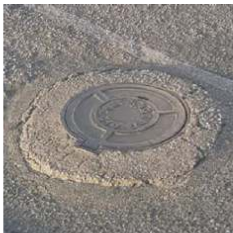
Figura D143 - Nível de deterioração médio
