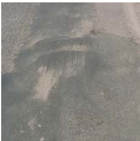
Figura R54 - Nível de deterioração alto
