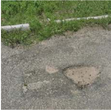
Figura P70 - Nível de deterioração baixo
