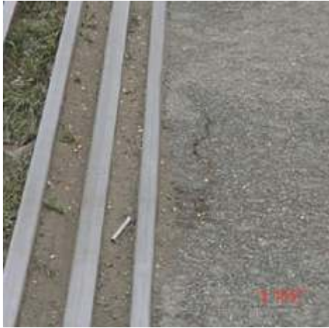
Figura S124 - Nível de deterioração baixo
