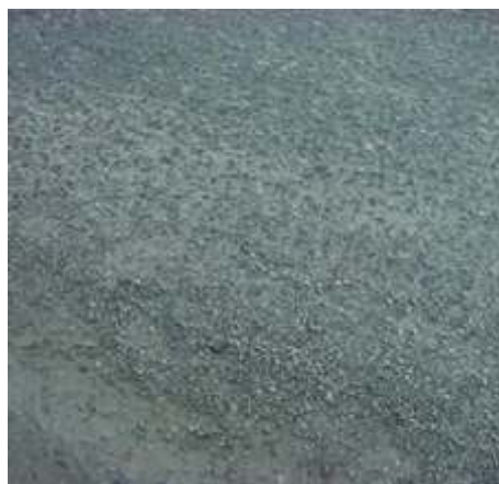
Figura S85 - Soltamento do Agregado da mistura asfáltica [Fonte: Rua Almirante Barroso, Campina Grande/PB]
