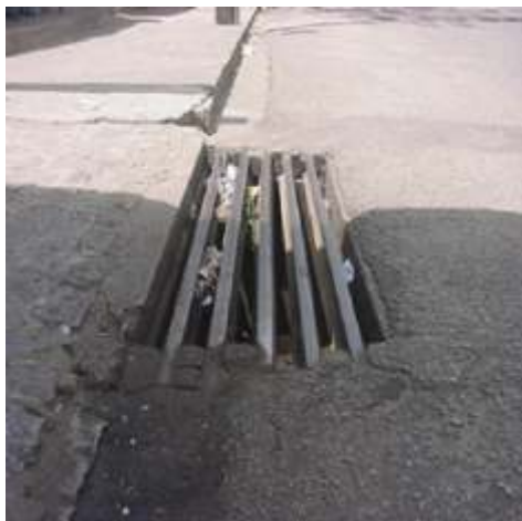
Figura D148 - Nível de deterioração baixo
