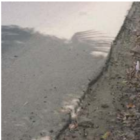
Figura S113 - Nível de deterioração médio
