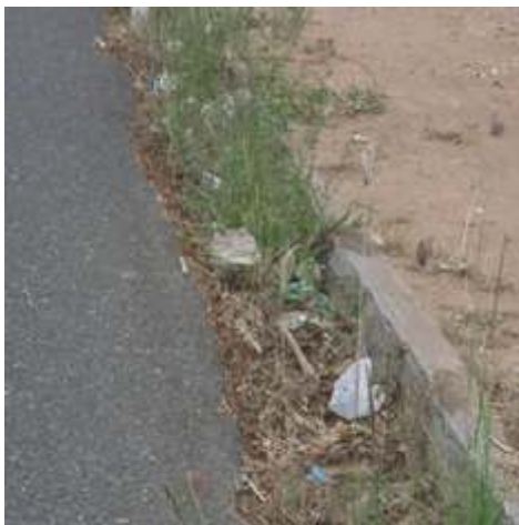
Figura D155 - Nível de deterioração médio
