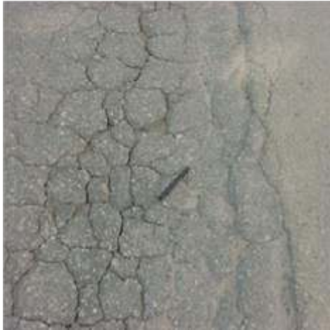
Figura T4 - Nível de deterioração baixo
