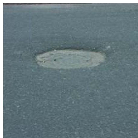
Figura D133 - Afundamento do tampão do Poço de Visita [Fonte: Rua Martins Junior, Campina Grande/PB]
