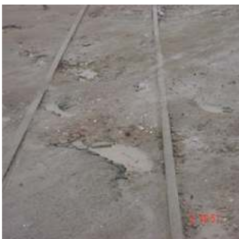
Figura S126 - Nível de deterioração alto
