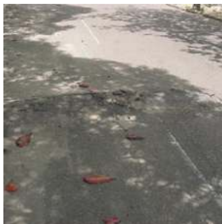
Figura S115 - Ruptura do revestimento por Raízes de árvores. [Fonte: Rua Basílio Araújo, Campina Grande/PB]
