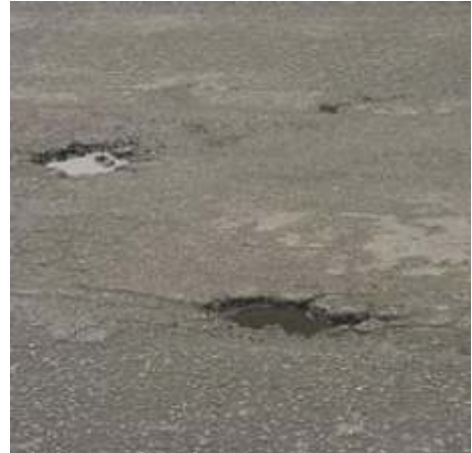
Figura P67 - Painelas de Deterioração [Fonte: Av. Assis Chateaubriand, Campina Grande/PB]
