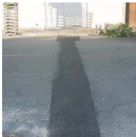
Figura R55 - Remendo formando “Lombada” [Fonte: Rua Padre Anchieta Campina Grande/PB]
