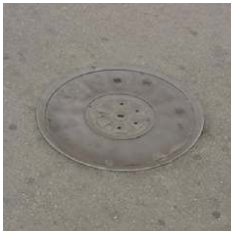
Figura D142 - Nível de deterioração baixo
