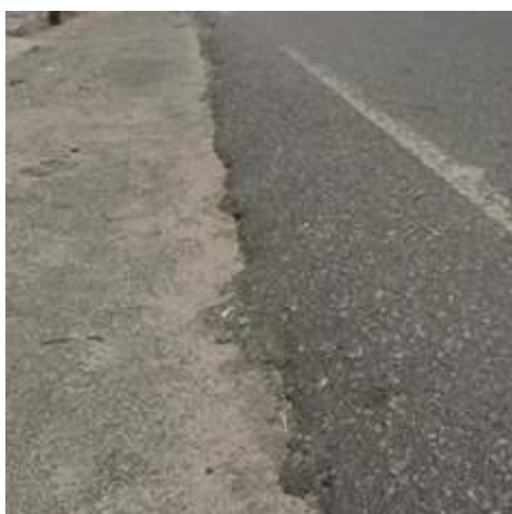
Figura S108 - Nível de deterioração alto
