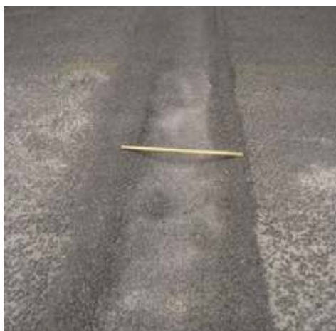
Figura R65 - Nível de deterioração médio
