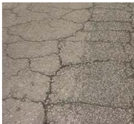
Figura T7 - Trincas em Blocos [Fonte: São José da Mata, Campina Grande/PB]
