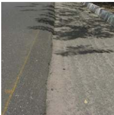
Figura S107 - Nível de deterioração médio
