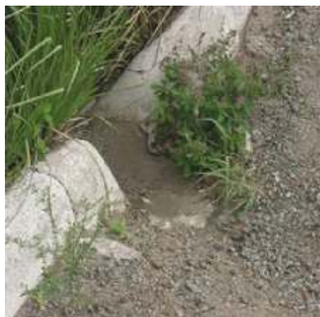
Figura D151 - Entupimento das Sarjetas [Fonte: Av. Januncio Ferreira, Campina Grande/PB]
