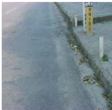
Figura S73 - Afundamento de Trilha de Roda [Fonte: Rua Vigário Calisto, Campina Grande/PB]
