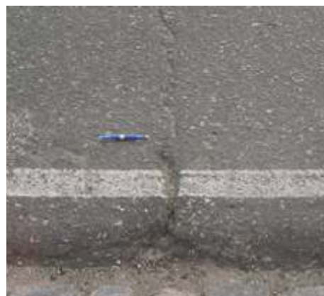
Figura T19 - Trincas de Canto (Fonte: Avenida Brasília, Campina Grande/PB)
