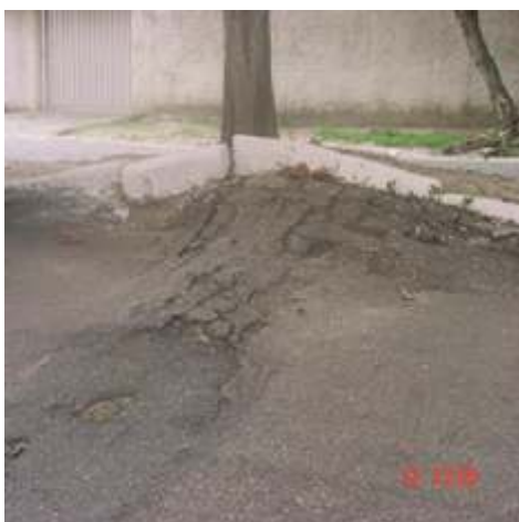
Figura S120 - Nível de deterioração alto
