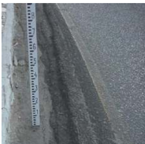
Figura S96 - Nível de deterioração alto
