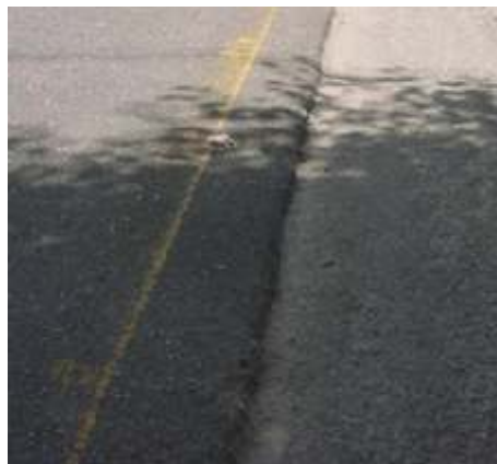
Figura S103 - Desnível acentuado entre a Pista e o Acostamento [Fonte: Av. Januncio Ferreira, Campina Grande/PB]
