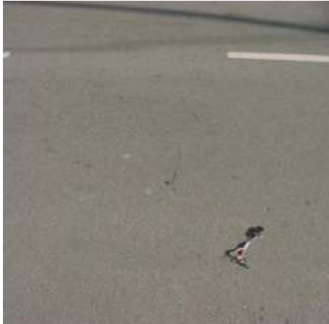
Figura T34 - Nível de deterioração baixo
