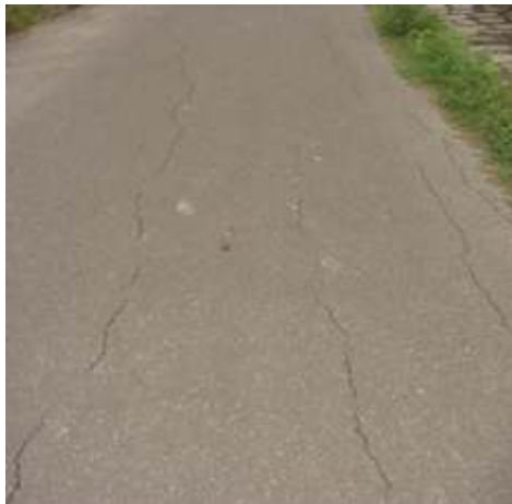
Figura T28 - Nível de deterioração baixo
