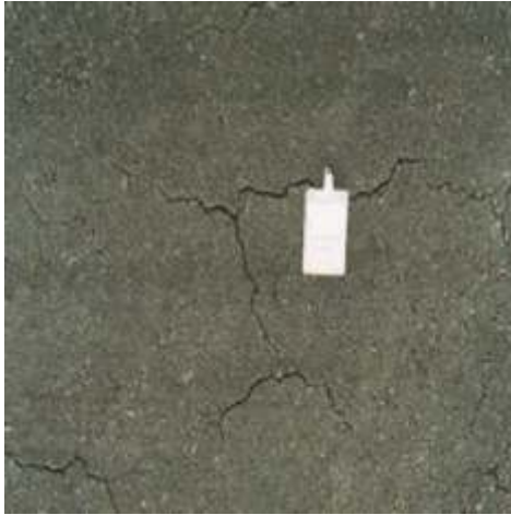
Figura T10 - Nível de deterioração baixo
