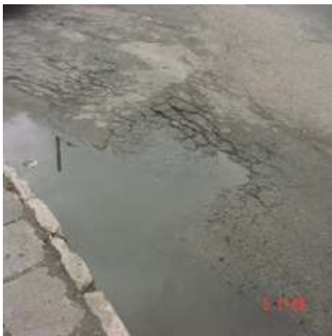
Figura D167 - Nível de deterioração médio
