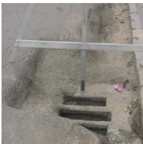
Figura D150 - Nível de deterioração alto
