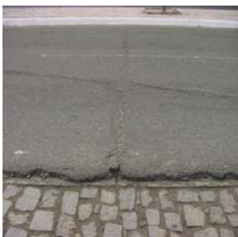
Figura T42 - Nível de deterioração alto
