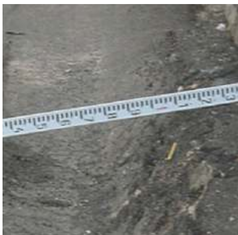
Figura S78 - Nível de deterioração alto
