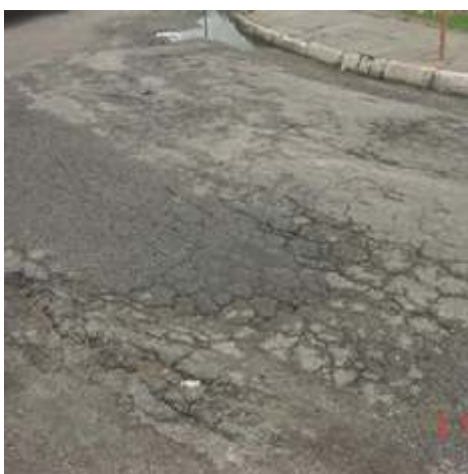
Figura D168 - Nível de deterioração alto
