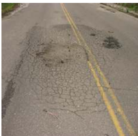
Figura T18 - Nível de deterioração alto
