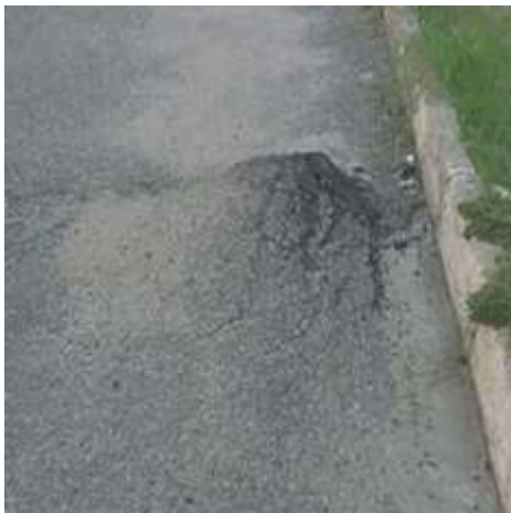
Figura S131 - Nível de deterioração médio
