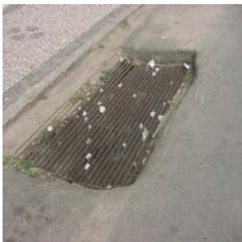
Figura D149 - Nível de deterioração médio
