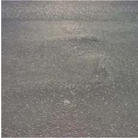
Figura S130 - Nível de deterioração baixo
