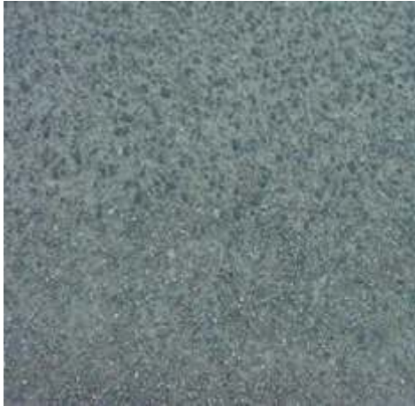
Figura S88 - Nível de deterioração baixo
