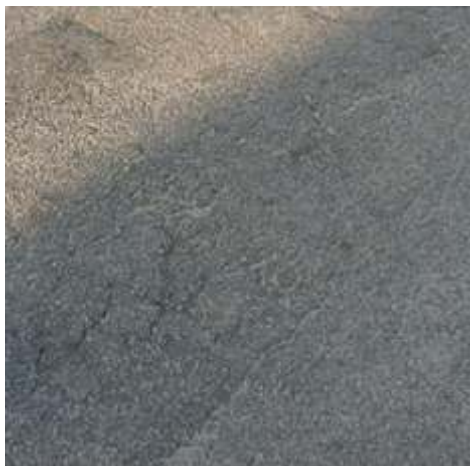
Figura S82 - Nível de deterioração baixo
