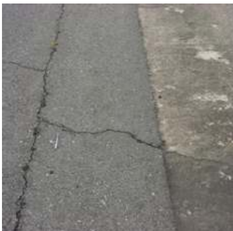
Figura T24 - Nível de deterioração alto
