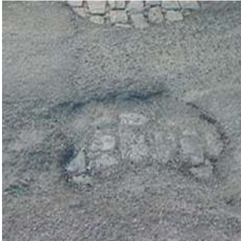
Figura S100 - Nível de deterioração baixo
