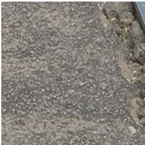
Figura S125 - Nível de deterioração médio
