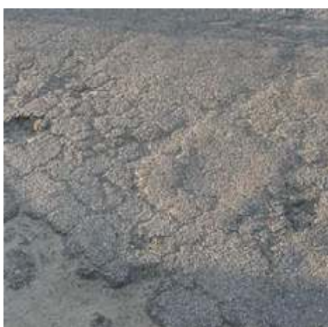
Figura S84 - Nível de deterioração alto
