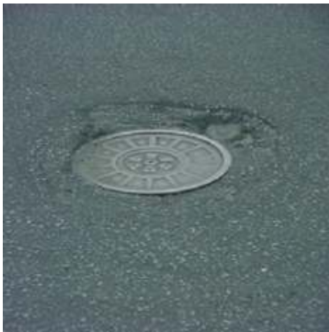
Figura D137 - Nível de deterioração médio
