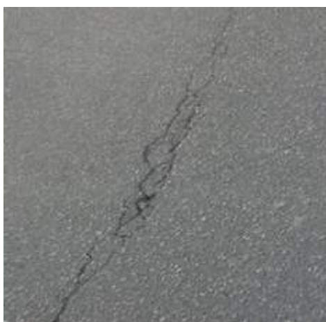
Figura T30 - Nível de deterioração alto
