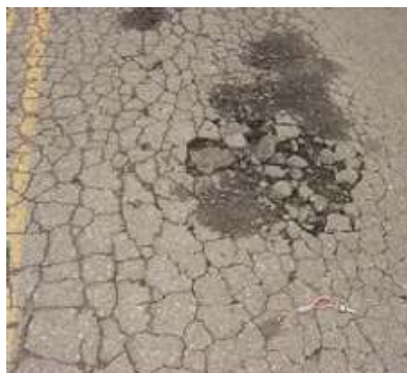
Figura T13 - Trincas couro de Jacaré [Fonte: Rua Professor Lenier Sucupira Meira de Almeida, Campina Grande/PB]
