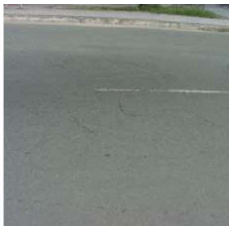
Figura T31 - Trincas Transversais [Fonte: Av. Floriano Peixoto, Campina Grande/PB]
