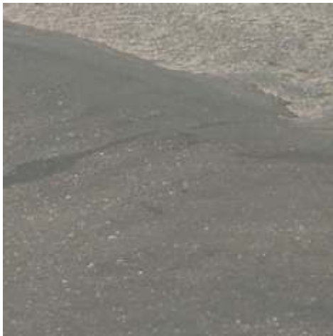
Figura R53 - Nível de deterioração médio
