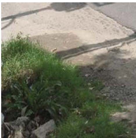
Figura D156 - Nível de deterioração alto
