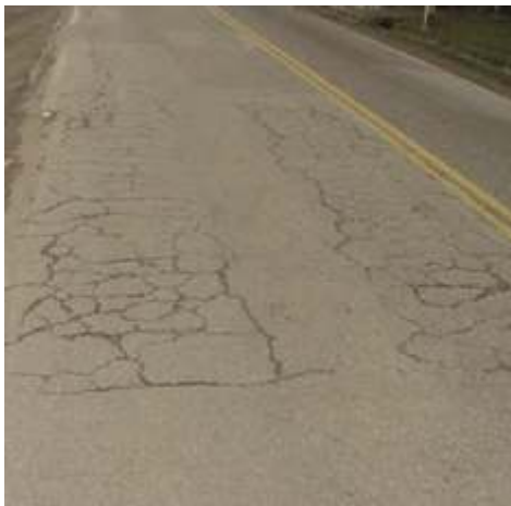
Figura R47 - Nível de deterioração médio
