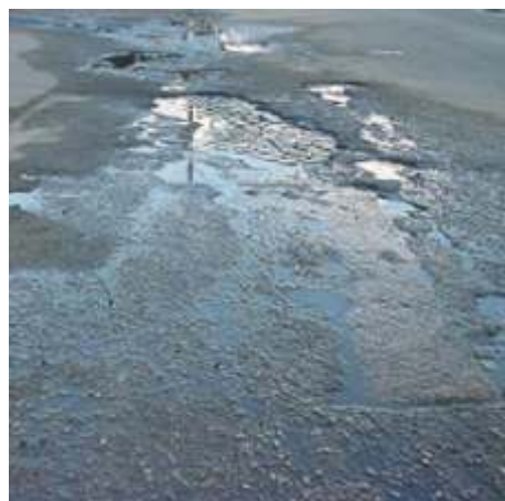
Figura D157 - Falta de Drenagem Superficial [Fonte: Rua Elpídio de Almeida, Campina Grande/PB]
