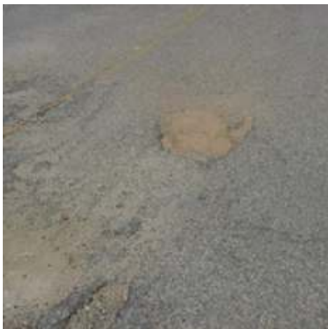
Figura P71 - Nível de deterioração médio
