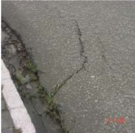
Figura T22 - Nível de deterioração baixo
