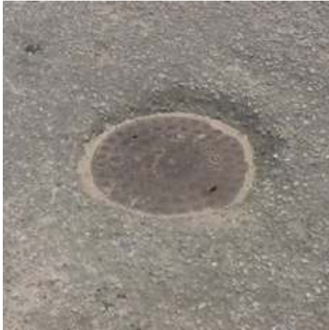
Figura D136 - Nível de deterioração baixo
