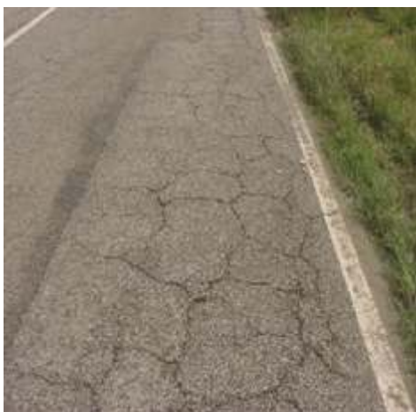
Figura R48 - Nível de deterioração alto
