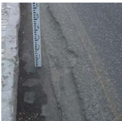
Figura S95 - Nível de deterioração médio
