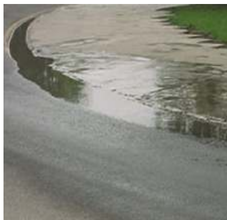
Figura D163 - Falta de Equipamentos Drenagem subterrânea [Fonte: Rua Elpidio de Almeida, Campina Grande/PB]
