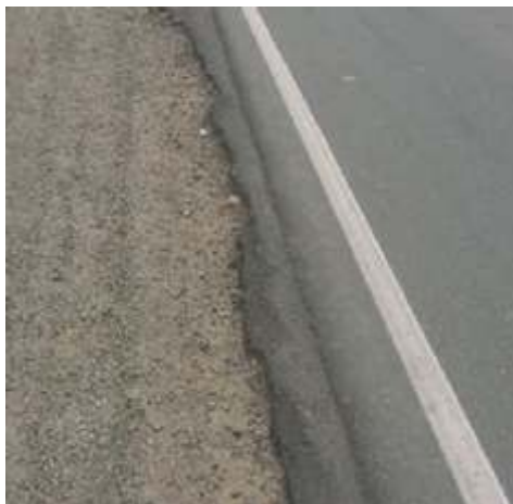
Figura S94 - Nível de deterioração baixo
