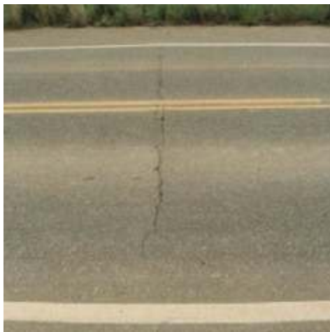
Figura T40 - Nível de deterioração baixo
