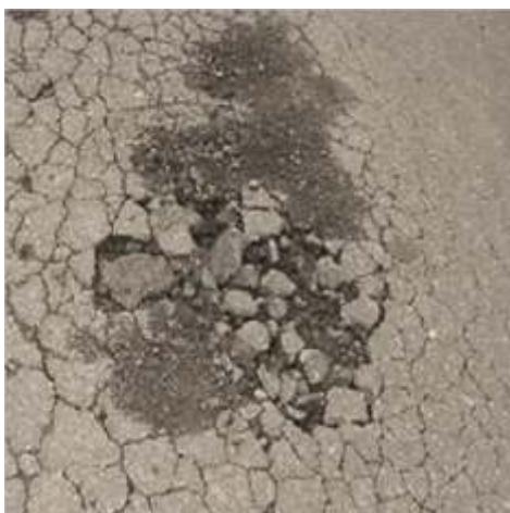
Figura T6 - Nível de deterioração alto
