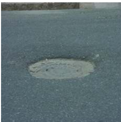
Figura D138 - Nível de deterioração alto
