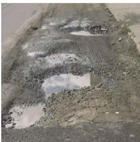
Figura D162 - Nível de deterioração alto
