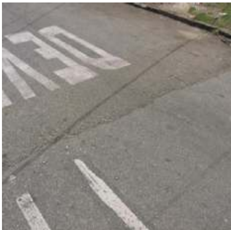
Figura R59 - Nível de deterioração médio
