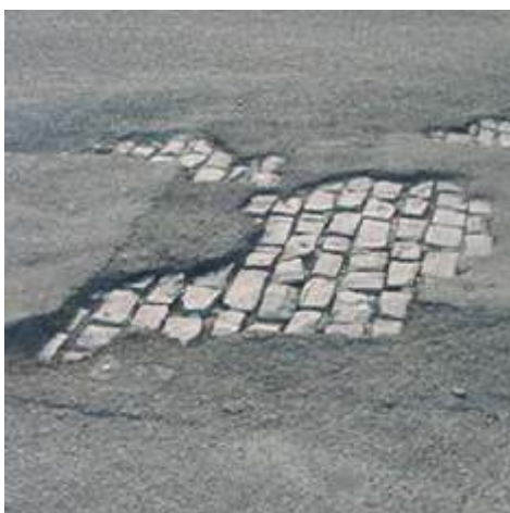
Figura S102 - Nível de deterioração alto
