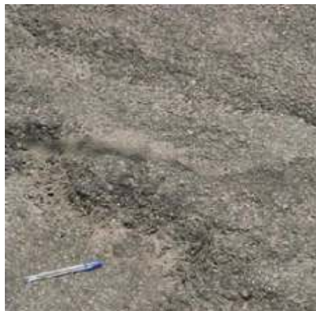
Figura S79 - Envelhecimento da Mistura Asfáltica [Fonte: Av. Almirante Barroso, Campina Grande/PB]
