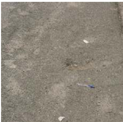
Figura S89 - Nível de deterioração médio
