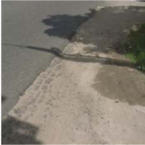
Figura S112 - Nível de deterioração baixo
