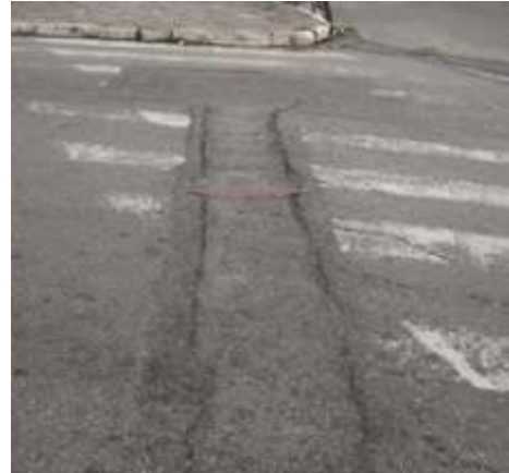
Figura R61 - Remendo formando “Sarjeta” [Fonte: Rua Nilo Peçanha Campina Grande/PB]
