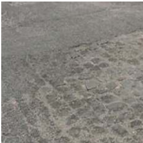
Figura S101 - Nível de deterioração médio
