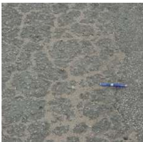
Figura S83 - Nível de deterioração médio
