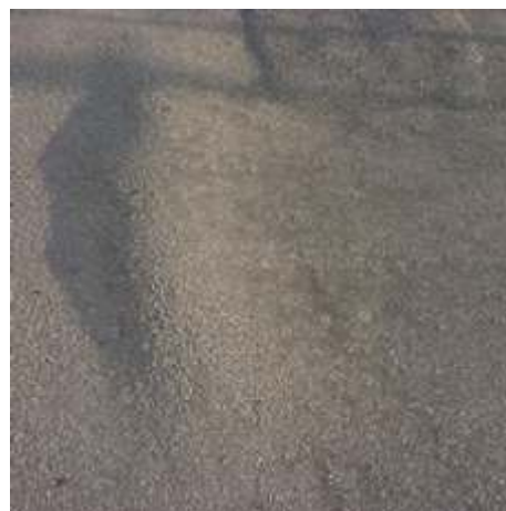
Figura S127 - Escorregamento do Revestimento [Fonte: Rua Anacleto Eloy Campina Grande/PB]
