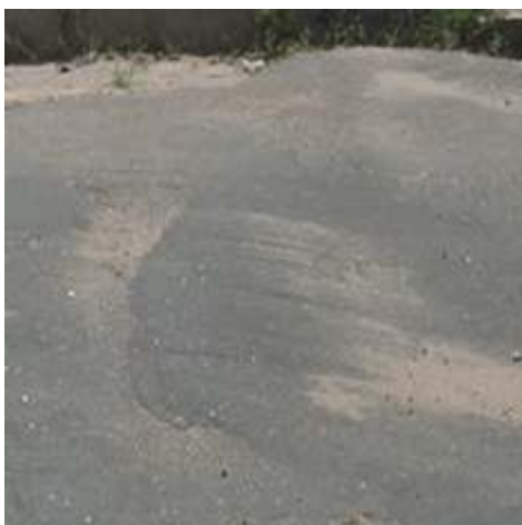
Figura S132 - Nível de deterioração alto
