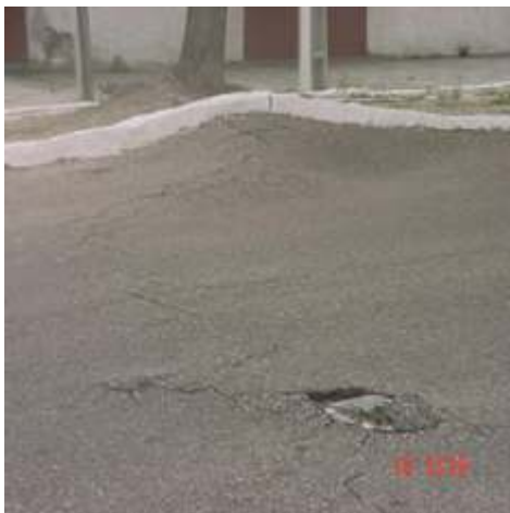
Figura S119 - Nível de deterioração médio
