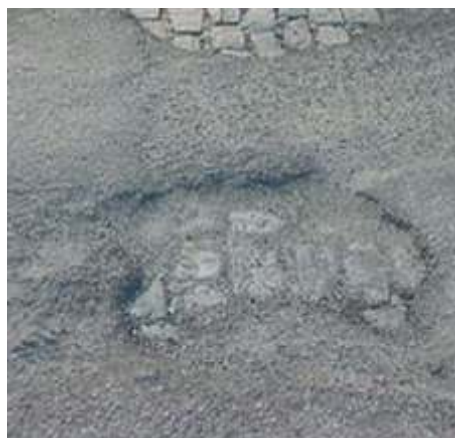
Figura S97 - Falta de aderência entre o Asfalto e a superfície do Paralelepípedo [Fonte: Avenida Elpídio de Almeida, Campina Grande/PB]
