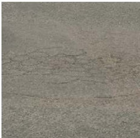
Figura T16 - Nível de deterioração baixo
