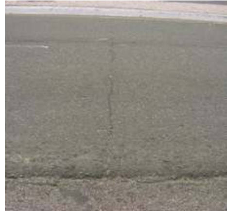
Figura T37 - Trincas de Reflexão [Fonte: Av. Brasília, Campina Grande/PB]
